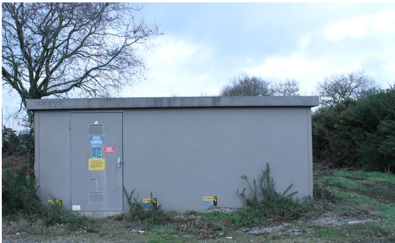
Photo 2 : Poste de livraison du parc de Derval-Lusanger à Derval
