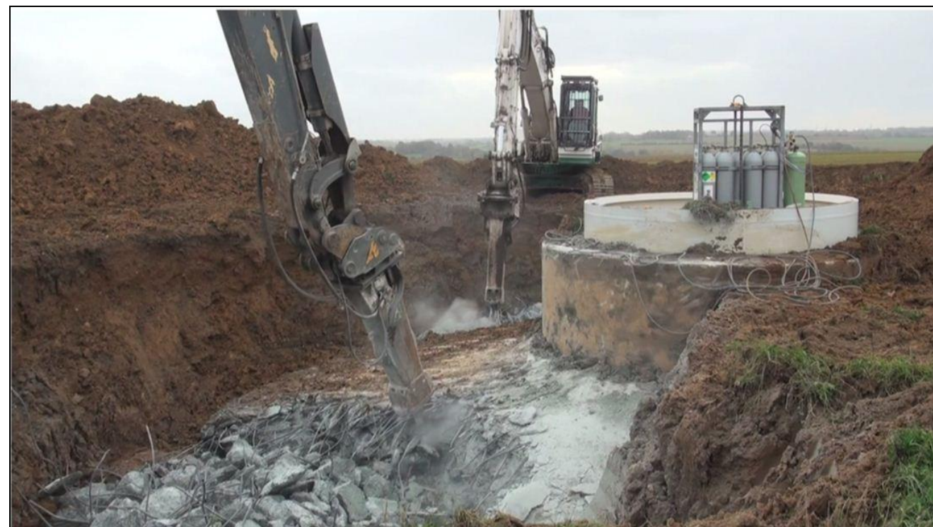
Photo 11: Destruction de la fondation par brise roche hydraulique
